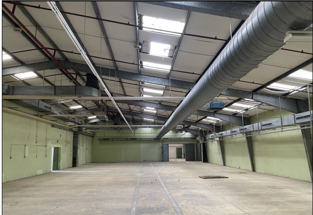
Abb. 23: Halleninneres, Erdgeschoss mit Belüftungsanlagen (Beispielbild, Quelle: H & P)
