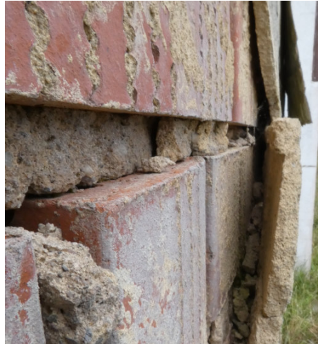
Abb. 21: Potenzielle Spaltenquartiere im Bereich von Putzabplatzungen (beispielhaft; hier am Nordende der südwestlichen Gebäudelängsseite, ca. auf Brusthöhe, Quelle: H & P)
