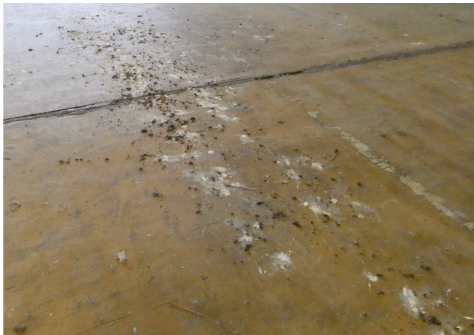
Abb. 29: Kotspuren im Bereich der nördlichen Hallen unweit einer fehlenden Fensterfront (Quelle: H & P)
