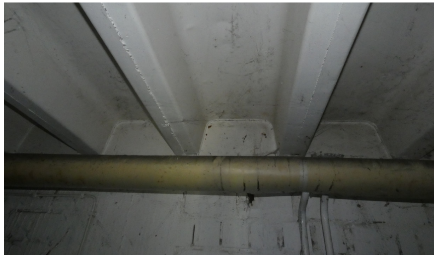
Abb. 25: Beispielbild Leitungsverläufe Kellergeschoss unterhalb entlang Kellerdecke (Quelle: H & P)
