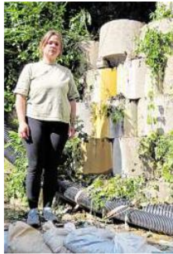
Laura Bauer: Die Pflanzkübel aus Beton sind gerissen, die gelb-weiße Brühe strömte unaufhaltsam auf das Gelände.
